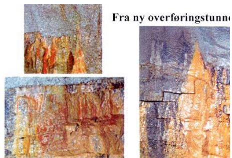
Figur 4: Vekst av brunt bakterieslam i vann fra sprekker i fjell. Redigert av Eyvind A. Andersen, FHI.
