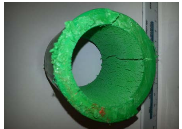
Figur 5.2: Høyt trykk og høy temperatur kan redusere levetiden for drikkevannsrør. Dette varmtvannsrøret måtte byttes ut etter ett års bruk fordi det vart utsatt for høyere trykk og temperatur enn det er dimensjonert for (Foto: Johan Ljungqvist)
