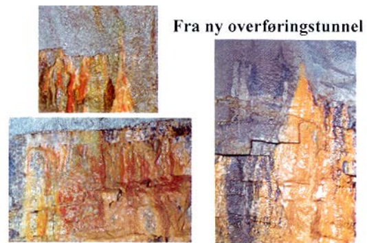
Figur 2.10: Begroing på vegg i råsprengt tunnel med sig av vann fra overliggende myrer. Til venstre heterotrofe bakterier samt jern- og manganbakterier, til høyre vekst av jernbakterien Gallionella (Foto: Kari Ormerod)
