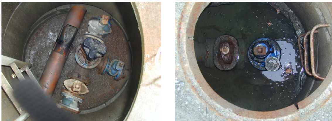
Figur 5.9: Godt drenert felleskum for spillvannsrør og drikkevannsrør påmontert brannventil (bildet til venstre), og dårlig drenert vannfylt kum med stengbar brannventil. Disse løsningene medfører ulike grader av forurensningsrisiko for drikkevannsrøret (foto: Hans Hatmyr, Trondheim kommune)
