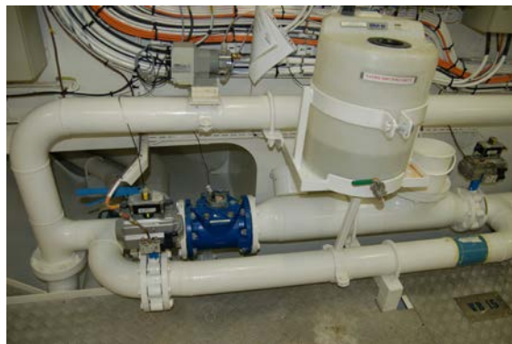
Figur 2.6: Ved vannbehandling anvendes ofte kjemikalier, slik som her ved klorering av drikkevann. Tilsetningsstoffer til drikkevann skal være godkjent av Mattilsynet, og skal kun doseres i tillatte mengder (Foto: Eyvind Andersen)
