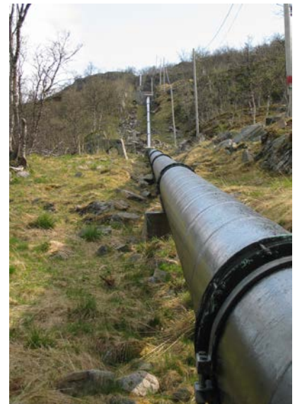
Figur 5.1: Overføringsrør (Foto: Eyvind Andersen)
