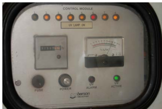
Figur 6.2: Dersom man under internrevisjonen for eksempel avdekker at UV-anlegget ikke drives korrekt (her er anlegget i drift, på tross av at én UV-lampe ikke virker og én indikatorlampe ikke virker), må man korrigere feil, samtidig som man avdekker hva som har sviktet og hvordan dette kan unngås i fremtiden. Er driftsrutiner, styrende dokumentasjon eller opplæring mangelfulle i dette tilfellet? (Foto: Eyvind Andersen)
