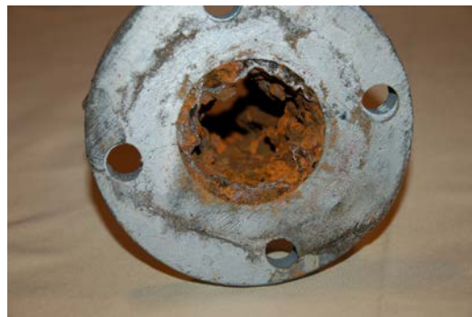
Figur 2.11: Korrodert drikkevannsrør hvor utfelt jernoksid (rustknoller) både kan gi gode forhold for oppvekst av biofilm, samt føre til problemer med lukt, smak og misfarging av vannet (Foto: Eyvind Andersen)
