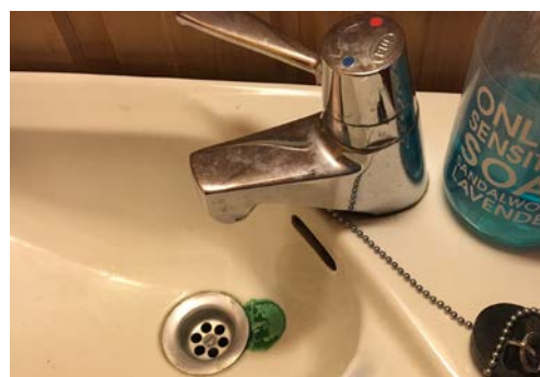
Korrosjon på kobber Figur 2.12: Grønnfarging av porselenet i vasken er en følge av at vannet er korrosivt og tærer på kobberrør (Foto: Eyvind Andersen)
