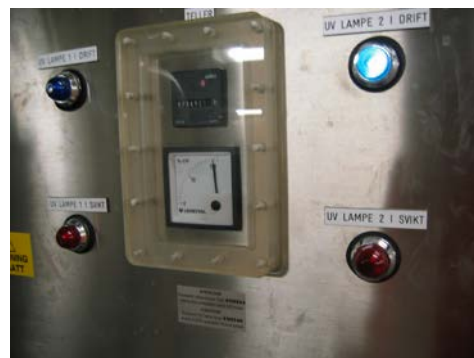
Figur 4.15: Kontrollskap for UV-anlegg. Signallys viser om UV-lampene lyser, timetelleren (sort) angir hvor lenge anlegget har vært i drift, og intensitetsmåleren (hvit) viser lysintensiteten inne i UV-kammeret (Foto: Eyvind Andersen).
