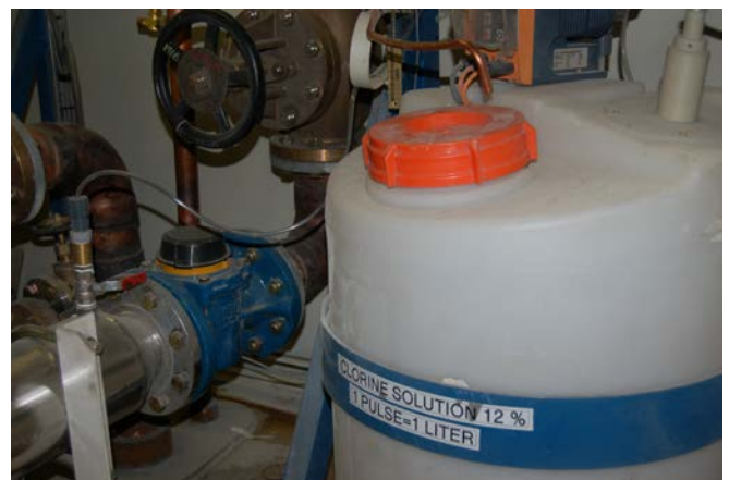
Figur 4.9: Vannmengdestyrt kloreringsanlegg på en offshoreinnretning. Vannmengdemåleren (blå ventil) gir signaler som regulerer klorpumpa (Foto: Eyvind Andersen)
