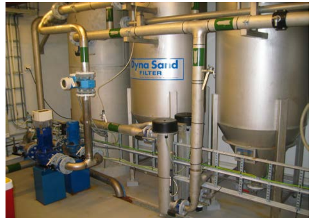
Figur 4.7: Filtreringsanlegg (Foto: Jens Erik Pettersen)
