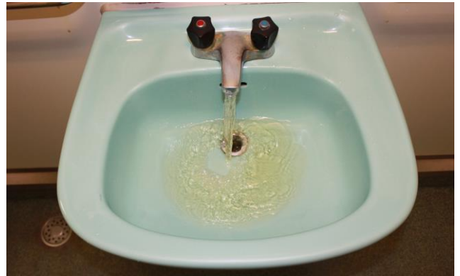
Figur 4.3: Misfarget drikkevann som følge av rørrkorrosjon (Foto: Eyvind Andersen)
