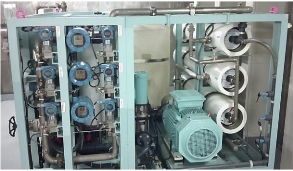
Figur 6.7: Omvendt osmoseanlegg. Membranene er i en rull inne i de hvite rørene (Foto: Eyvind Andersen)
