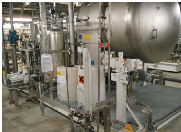
Figur 1.1: Drikkevannsanlegg med evaporator, avleiringshemmertank, klortank, alkaliseringsfilter og UV-anlegg (Foto: Eyvind Andersen)
