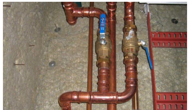
Figur 4.7: Korrosivt vann i kobberør kan føre til for høye kobberverdier i drikkevannet (Foto: Bjørn Løfsgaard)
