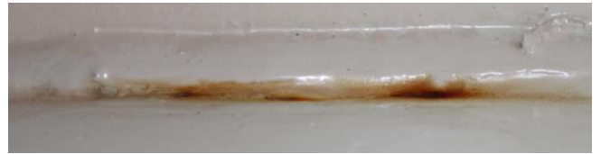
Figur 9.8: Manglende vasking av saltrester i sveiseskjøt før tanken ble malt har ført til korrosjonsgjennomslag (Foto: Bjørn Løfsgaard)
