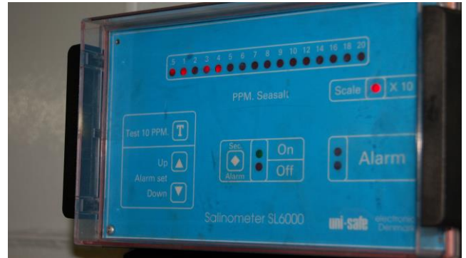
Figur 6.8: En konduktivitetsmåler sørger for at produsert vann automatisk sjekkes, og dumpes dersom grenseverdien overskrides (Foto: Eyvind Andersen)
