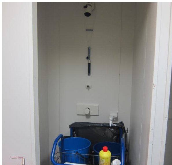
Figur 9.13: Denne dusjen er ikke i bruk, og blir i stedet brukt som lagerplass. Vannet i slike rør holder romtemperatur og vil kunne bli et opp- vekststed for blant annet Legionella og deretter pode resten av drikkevannssystemet med forurens- ning. Rørstrekk som ikke er i bruk bør fjernes fra drikkevannssystemet, alternativt må de spyles ukentlig (Foto: Eyvind Andersen)
