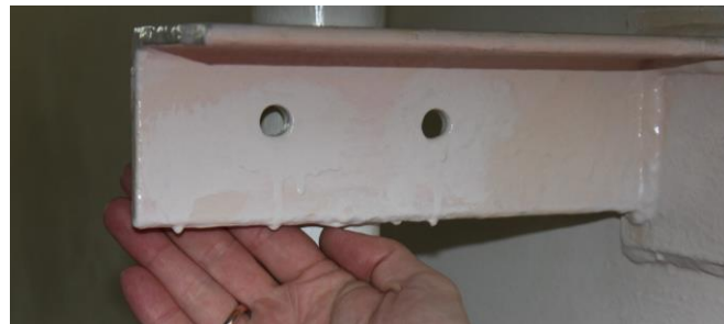
Figur 9.11: Feil påføring av belegg har ført til korrosjon og flere runder med flekkmaling. Belegget er påført for tykt, ved feil temperatur og med feil metoder noe som gir økt risiko for oppvekst av mikrober og for at det skal oppstå problemer med lukt og smak etter maling (Foto: Eyvind Andersen)
