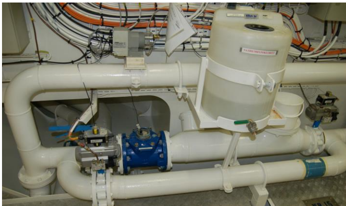
Figur 8.3: Mengdestyrt kloreringsanlegg, trygt plassert i et skap (Foto: Eyvind Andersen)
