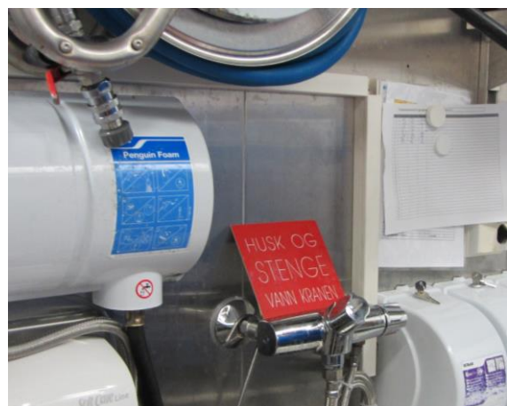
Figur 9.19: Ettgreps slangestasjon hvor det er lekkasje mellom varmt og kaldt vann når blande-batteriet står åpent mens slangen ikke er i bruk. Et skilt er ikke tilstrekkelig beskyttelse mot slik lekkasje (Foto: Eyvind Andersen)
