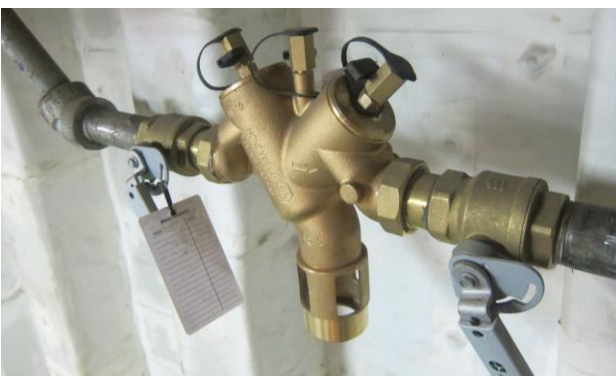
Figur 9.17: Der andre væskesystemer må forsynes med drikkevann med trykk, gir en ventil av type "BA" best beskyttelse. Legg merke til de tre testportene på ventilens topp. En slik ventil må utstyres med forfilter og stoppventiler som muliggjør testing, og bør plasseres over et sluk da den dreneres automatisk (Foto: Eyvind Andersen)
