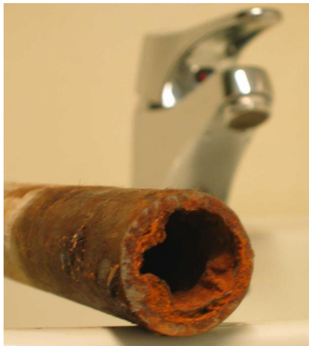
Figur 4.4: Rustknoller kan gi dårlig vann og føre til gjentetting av rør (Foto: Eyvind Andersen)
