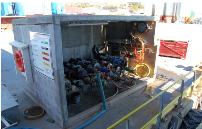
Figur 7.1: Bunkringsstasjon på forsyningsbase. Vann kan være forurenset før det kommer ut til basen, og ved dårlige rutiner på forsyningsbasen kan både bunkringstilkoplinger og -slanger være forurenset (Foto: Eyvind Andersen)
