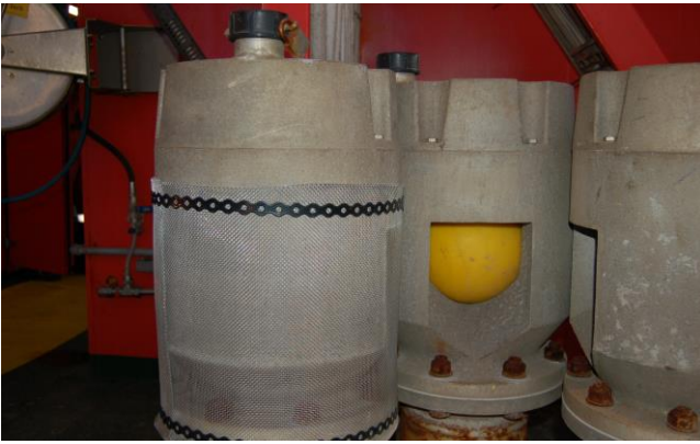
Figur 9.3: Luftør for drikkevannstanker må sikres tilstrekkelig. På bildet vises rør som er sikret med ball og netting i finmasket, korrosjonsbestandig materiale. Bildet er tatt på et nybygg, og luftørerne er ennå ikke merket (Foto: Eyvind Andersen)
