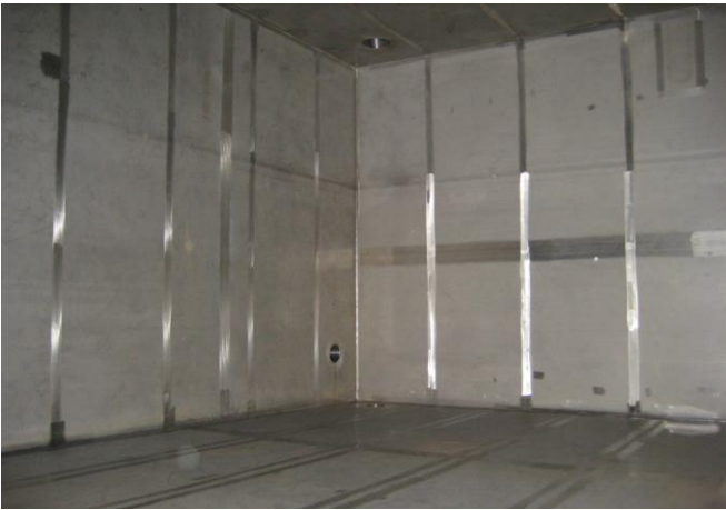
Figur 9.1: Ca 4 meter høy drikkevannstank i rustfritt stål, uten innvendige spant og avstivere. Slike tanker er lette å rengjøre, og man unngår problemer med påføring og vedlikehold av beskyttelsesbelegg (Foto: Bjørn Løfsgaard)
