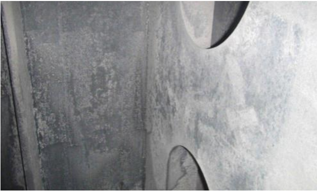
Figur 9.7: «Hvit rust» i drikkevannstank, som er utfelt sinkkarbonat. Tanken er malt med sinkholdig maling som kan brukes når pH er mellom 5,5 og 10. Ved høyere pH kan problemer med utfellinger, samt sinkholdig vann, oppstå. I dette tilfellet har pH-styringen vært for dårlig, da målt pH rundt 11 er langt utenfor drikkevannsforskriftens maksimalverdi på 9,5 (Foto: Tjarda den Dunnen)
