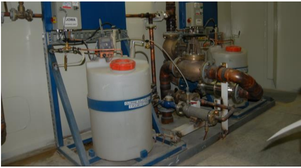
Figur 5.7: Lett tilgjengelig klortank som er godt merket og sikret (Foto: Eyvind Andersen)
