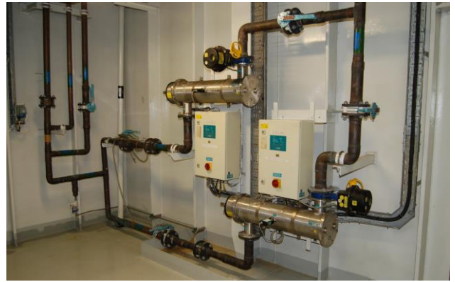
Figur 8.5: UV-anlegg med to strålingskamre. Hvert kammer har kontrollskap (hvitt) og UV-sensor (midt på) som stenger en ventil (svart) ved lav stråledose (Foto: Eyvind Andersen)
