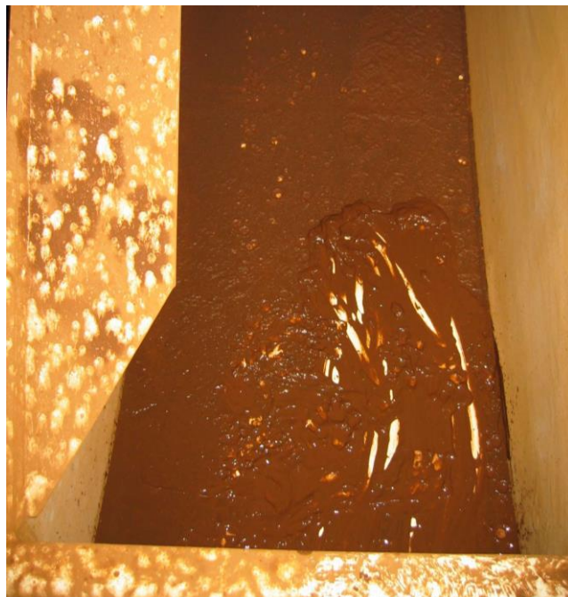
Figur 3.1: Kravet til årlig tankvedlikehold er satt for å unngå tilstander som dette, hvor det nærmest er et gjørmelag i bunnen av tanken. Slike forhold må avviksbehandles (Foto: Bjørn Løfsgaard)
