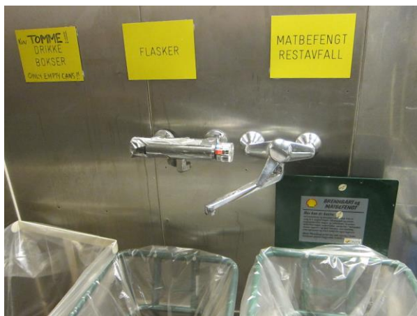
Figur 9.22: En vask har blitt fjernet uten at man har fjernet kraner og rør. Disse kranene er blindrør hvor Legionella kan ha gode oppvekstvilkår og siden spres til resten av drikkevannssystemet (Foto: Eyvind Andersen)
