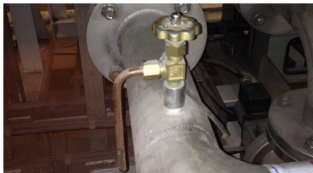
Figur 5.8: Kort og selvdrenerende prøvepunkt med liten rørdiameter. Kort avstand fra hovedrør til ventil gjør at stillestående vann unngås. Ved å plassere uttaket på oversiden unngår man at partikler legger seg i prøvepunktet. Rørenden kunne med fordel vært kortere for å lette desinfeksjon av prøvepunktet (Foto: Eyvind Andersen)
