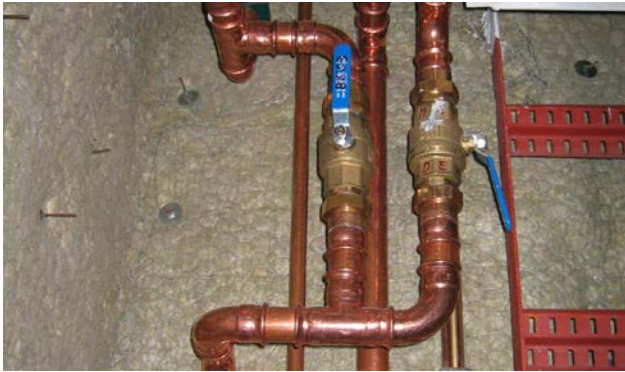
Figur 4.7: Korrosivt vann i kobberør kan føre til for høye kobberverdier i drikkevannet (Foto: Bjørn Løfsgaard)
