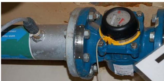
Figur 7.7: Displayet på vannmåleren vises til høyre, mens doseringspunktet for klor og klorslangen vises til venstre (Foto: Eyvind Andersen)
