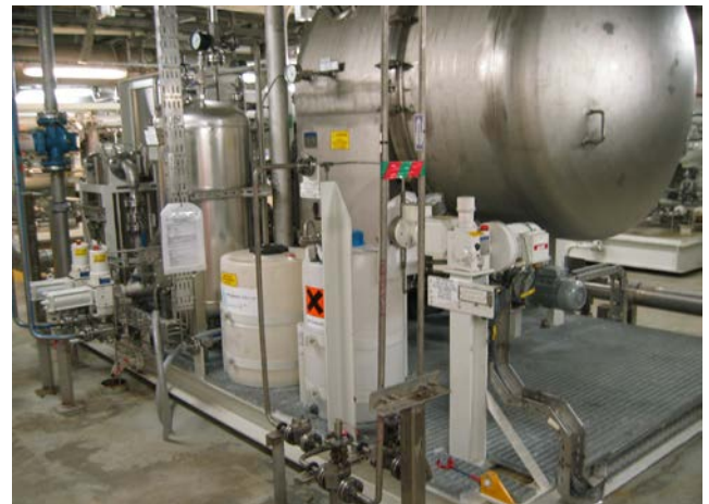
Figur 1.1: Drikkevannsanlegg med evaporator, avleiringshemmertank, klortank, alkaliseringsfilter og UV-anlegg (Foto: Eyvind Andersen)
