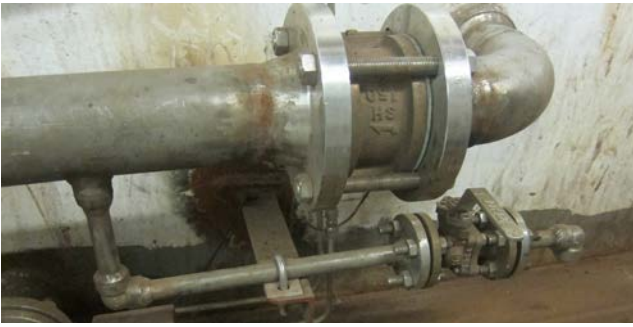
Figur 9.14: Prøvepunktøret er feildesignet da prøverøret er unødvendig langt og alt for grovt. Uttak på rørets underside er i tillegg uheldig da dette kan føre til oppvekst av biofilm grunnet smuss og partikler som ansamles, og vannprøvene blir derfor ikke representative (Foto: Eyvind Andersen)
