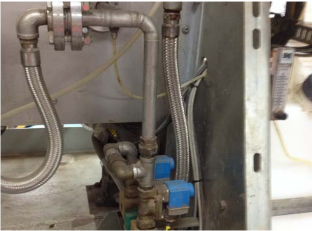
Figur 6.9: Evaporator med to uavhengig styrte (blå) dumpeventiler (Foto: Eyvind Andersen)
