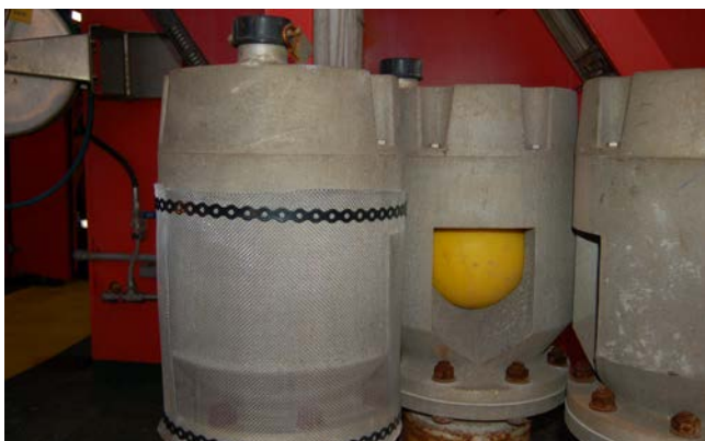
Figur 9.3: Luftør for drikkevannstanker må sikres tilstrekkelig. På bildet vises rør som er sikret med ball og netting i finmasket, korrosjonsbestandig materiale. Bildet er tatt på et nybygg, og luftørerne er ennå ikke merket (Foto: Eyvind Andersen)
