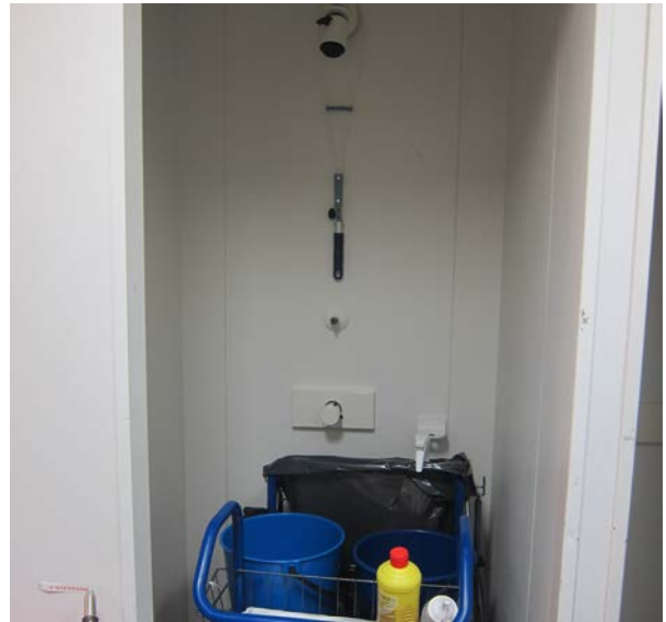
Figur 9.13: Denne dusjen er ikke i bruk, og blir i stedet brukt som lagerplass. Vannet i slike rør holder romtemperatur og vil kunne bli et opp- vekststed for blant annet Legionella og deretter pode resten av drikkevannssystemet med forurens- ning. Rørstrekk som ikke er i bruk bør fjernes fra drikkevannssystemet, alternativt må de spyles ukentlig (Foto: Eyvind Andersen)
