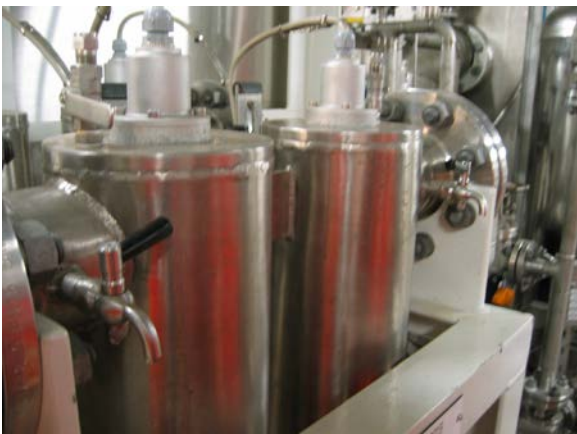
Figur 8.7: UV-anlegg med kraner som muliggjør vannprøver før og etter desinfeksjon (Foto: Eyvind Andersen)
