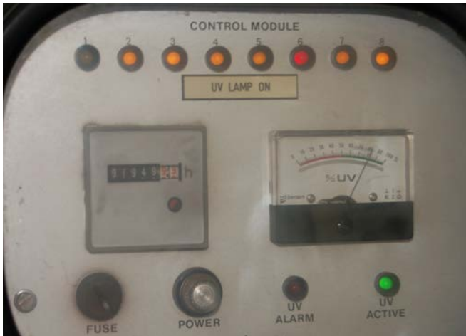
Figur 8.9: Kontrollpanel for UV-anlegg med åtte strålerør. Når rør 6 er defekt og varselpæren for rør 1 ikke virker, er ikke anlegget trygt å drive. Grunnen til at intensitetsmåleren fortsatt viser høy UV-intensitet kan være at vannet er svært klart eller at defekte rør ligger langt unna intensitets-sensorens målepunkt (Foto: Eyvind Andersen)
