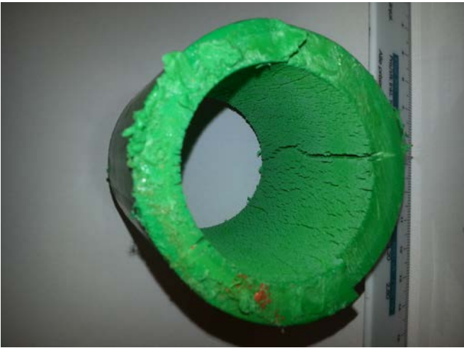
Figur 9.20: Varmtvannsrør som har blitt ødelagt som følge av manglende ekspansjonskar og en kombinasjon av høyt trykk og høy temperatur i varmtvannsnettet. (Foto: Johan Ljungqvist)
