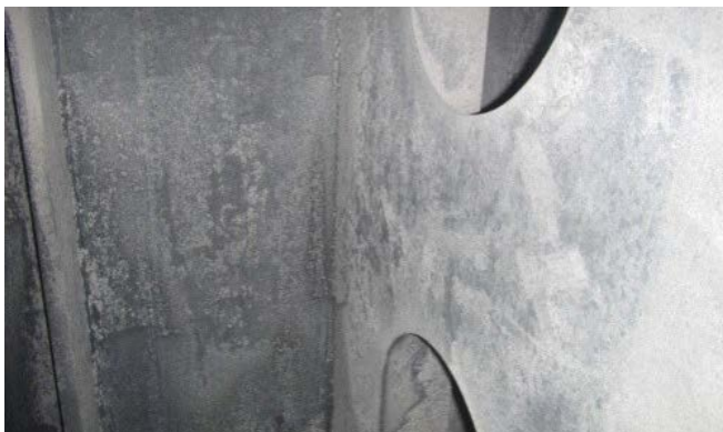
Figur 9.7: «Hvit rust» i drikkevannstank, som er utfelt sinkkarbonat. Tanken er malt med sinkholdig maling som kan brukes når pH er mellom 5,5 og 10. Ved høyere pH kan problemer med utfellinger, samt sinkholdig vann, oppstå. I dette tilfellet har pH-styringen vært for dårlig, da målt pH rundt 11 er langt utenfor drikkevannsforskriftens maksimalverdi på 9,5 (Foto: Tjarda den Dunnen)
