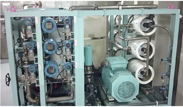
Figur 6.7: Omvendt osmoseanlegg. Membranene er i en rull inne i de hvite rørene (Foto: Eyvind Andersen)
