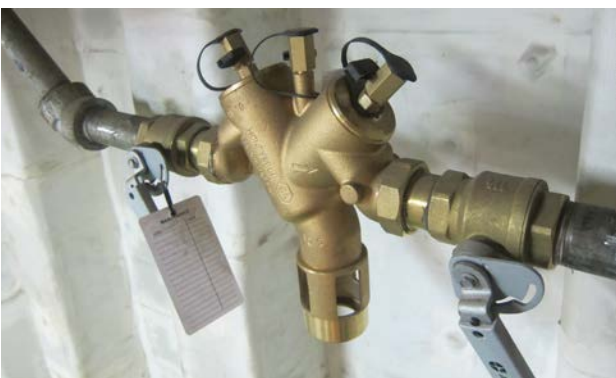
Figur 9.17: Der andre væskesystemer må forsynes med drikkevann med trykk, gir en ventil av type "BA" best beskyttelse. Legg merke til de tre testportene på ventilens topp. En slik ventil må utstyres med forfilter og stoppventiler som muliggjør testing, og bør plasseres over et sluk da den dreneres automatisk (Foto: Eyvind Andersen)
