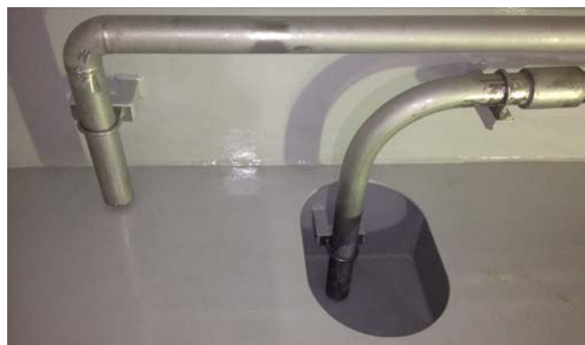
Figur 9.4: Tankens sugerør (til venstre) er hevet litt fra tankens bunn, mens dreneringsrør nede i sumpen i midten gjør det lett å tømme tanken for vann og skittent vaskevann (Foto: Eyvind Andersen)
