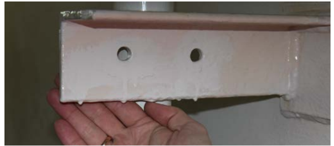
Figur 9.11: Feil påføring av belegg har ført til korrosjon og flere runder med flekkmaling. Belegget er påført for tykt, ved feil temperatur og med feil metoder noe som gir økt risiko for oppvekst av mikrober og for at det skal oppstå problemer med lukt og smak etter maling (Foto: Eyvind Andersen)
