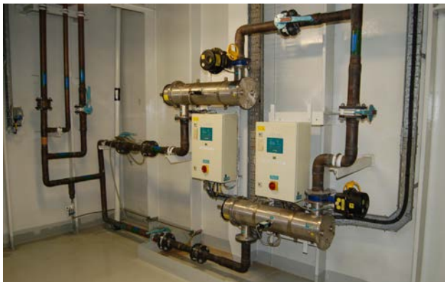
Figur 8.5: UV-anlegg med to strålingskamre. Hvert kammer har kontrollskap (hvitt) og UV-sensor (midt på) som stenger en ventil (svart) ved lav stråledose (Foto: Eyvind Andersen)
