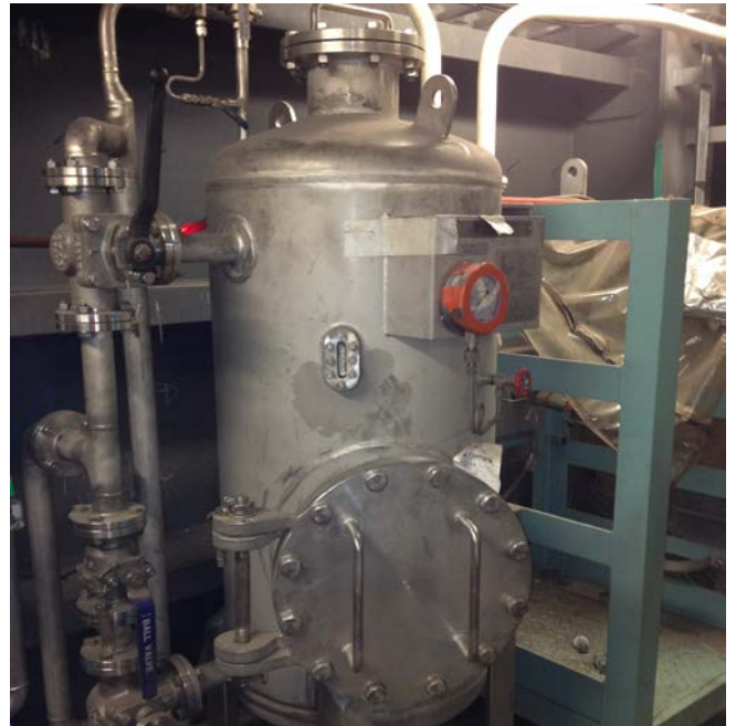
Figur 9.6: Også mindre tanker i drikkevannssystemet som trykktank, varmtvannsberedere og alkaliseringsfiltre må ha tilstrekkelig adkomstmulighet for innvendig vedlikehold. Tanken på bildet er laget av rustfritt stål, og den har gode mann hull (Foto: Eyvind Andersen)
