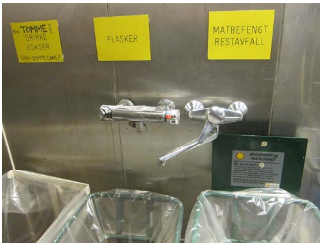
Figur 9.22: En vask har blitt fjernet uten at man har fjernet kraner og rør. Disse kranene er blindrør hvor Legionella kan ha gode oppvekstvilkår og siden spres til resten av drikkevannssystemet (Foto: Eyvind Andersen)
