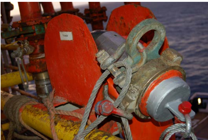
Figur 7.4: Bunkringslange med godt festet endeplugg (Foto: Eyvind Andersen)
