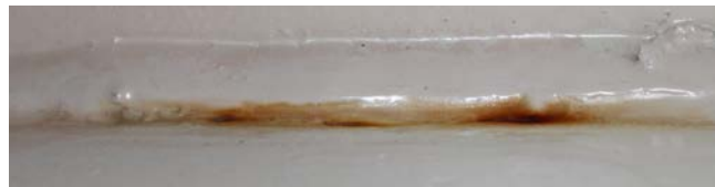
Figur 9.8: Manglende vasking av saltrester i sveiseskjøt før tanken ble malt har ført til korrosjonsgjennomslag (Foto: Bjørn Løfsgaard)
