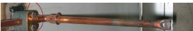
Figur 5.2: Under byggeprosessen bør ikke rørsystemet forurenses. Sammenklemt rørende hindrer forurensning (Foto: Bjørn Løfsgaard)
