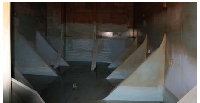
Figur 5.3: Denne drikkevannstanken er høy og mangler adkomstplattformer for rengjøring. Dette har resultert i dårlig vedlikehold. Veggene er ganske rene opp til to meters høyde, deretter blir de mer skitne, og over 4 meter er veggene brune av skitt (Foto: Eyvind Andersen)
