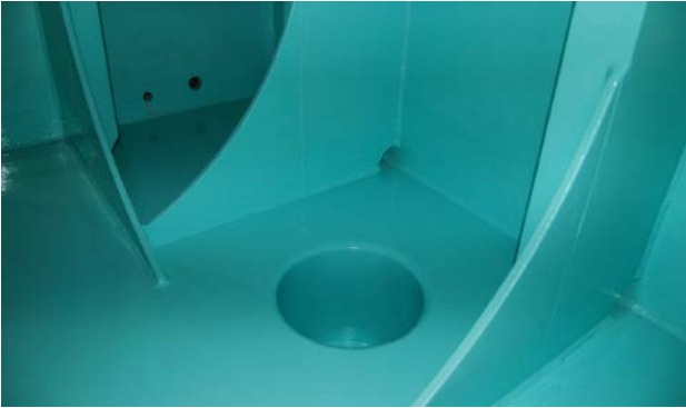
Figur 5.4: Denne tanken har dreneringssump og vertikale avstivere med utsparinger mot gulv, og er derfor lett å drenere (Foto: Eyvind Andersen)
