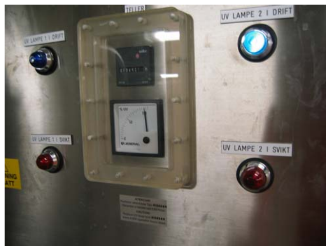
Figur 8.6: Kontrollpanel for UV-anlegg med to UV-strålerør. Blått lys viser at strålerør nummer to er i drift og fungerer. Midt på bildet skimtes timeteller (sort) og UV-intensitetsmålerskive (Foto: Eyvind Andersen)
