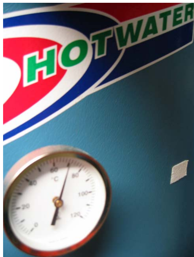
Figur 4.4: Ved å holde varmtvannstemperaturen høy nok, unngås oppvekst av Legionella (Foto: Eyvind Andersen)
