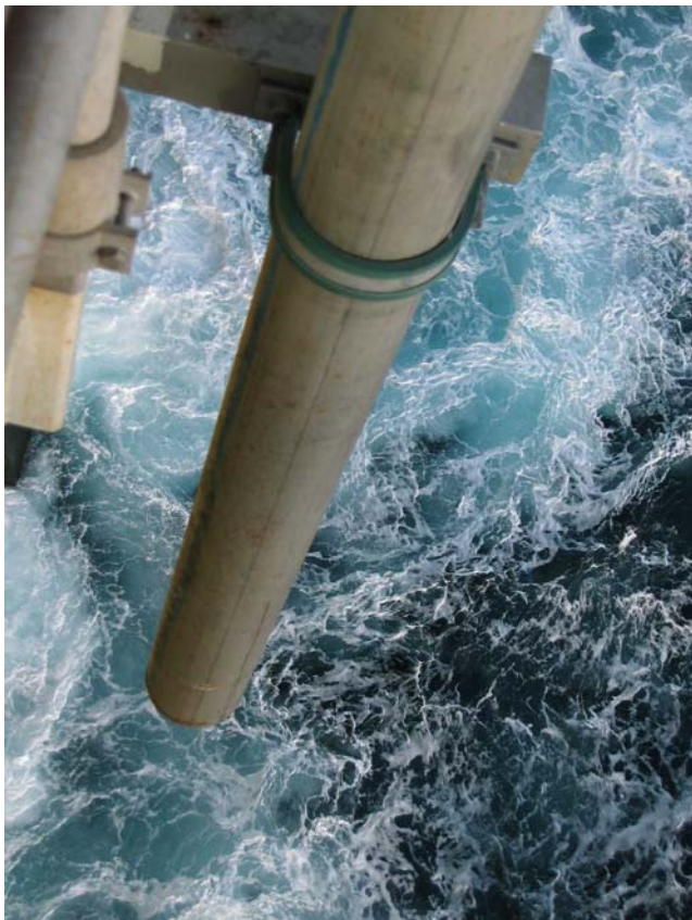
Figur 7.4: Når spylørøret er av samme dimensjon som bunkringslangen får man spylt med fullt trykk (Foto: Eyvind Andersen)
