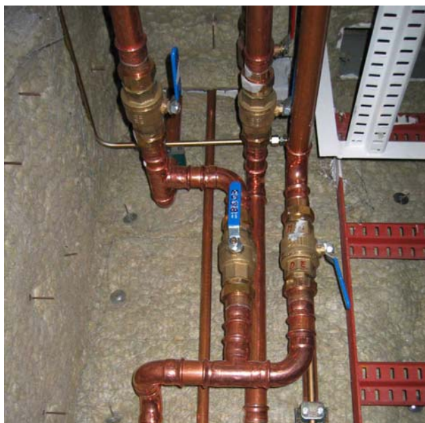
Figur 4.7: Korrosivt vann i kopperrør kan føre til for høye kopperverdier i drikkevannet (Foto: Bjørn Løfsgaard)
