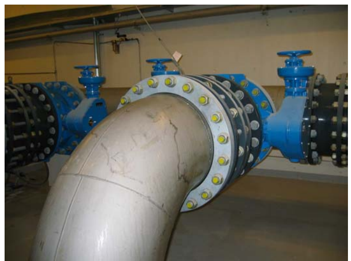
Figur 9.6: Rør og ventiler i drikkevannssystemer finnes i mange forskjellige størrelser og materialer. Man bør velge materialer som er korrosjonsbestandige, og som ikke gir opphav til biologisk vekst (Foto: Eyvind Andersen)
