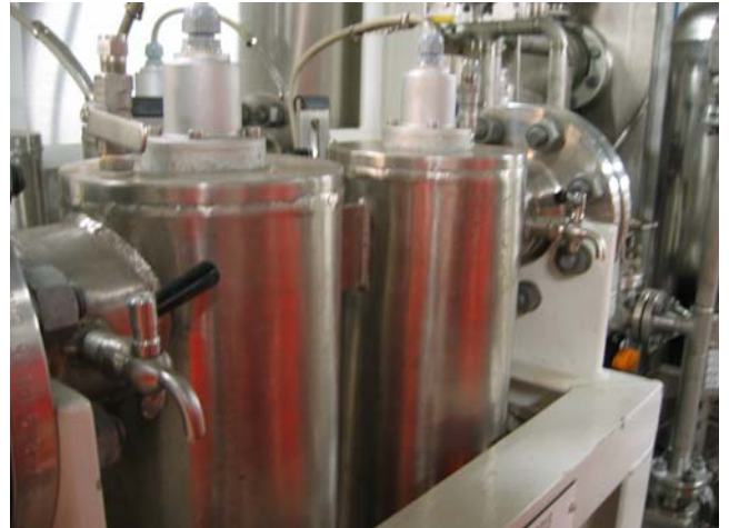
Figur 8.5: UV-anlegg med kraner som muliggjør vannprøver før og etter desinfeksjon (Foto: Eyvind Andersen)
