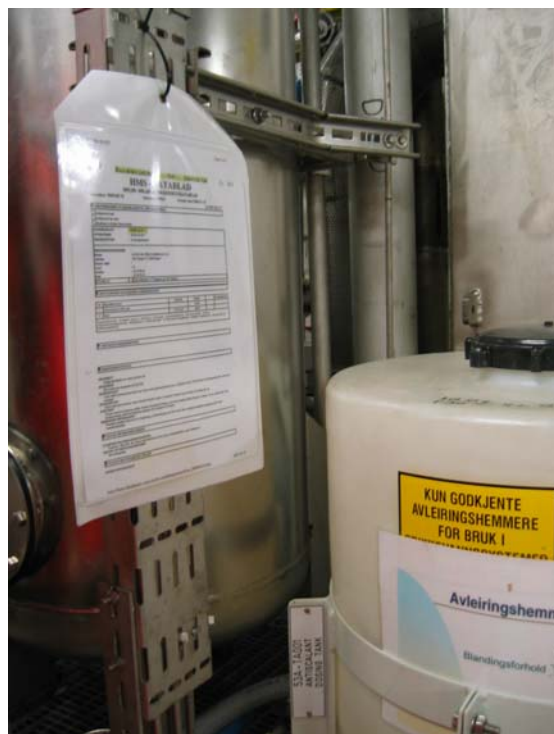
Figur 5.3: Godt merket og sikret tank for avleiringshemmer (Foto: Eyvind Andersen)
