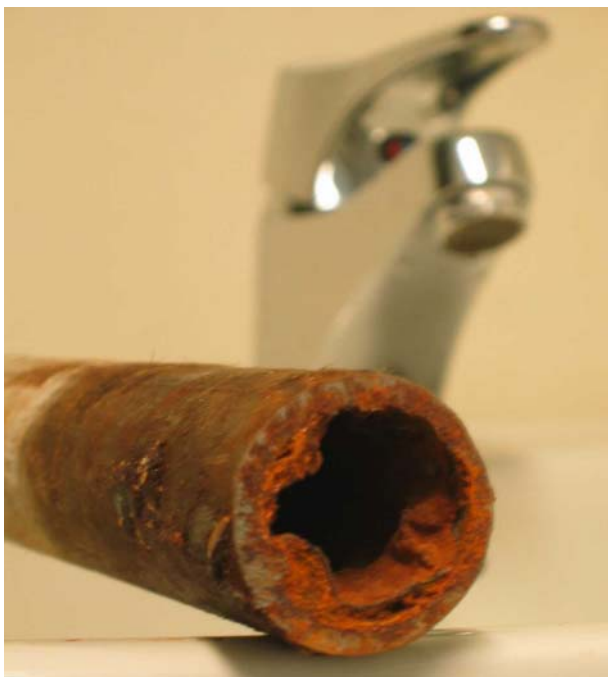
Figur 4.3: Rustknoller kan gi dårlig vann og føre til gjentetting av rør (Foto: Eyvind Andersen)
