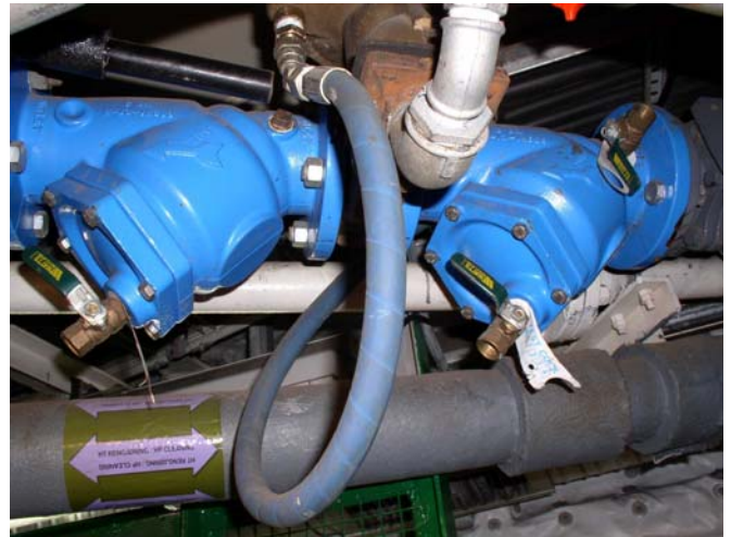
Figur 9.5: Andre væskesystemer bør ikke forsynes med drikkevann. Der dette ikke kan unngås, gir brutt forbindelse eller doble tilbakeslagsventiler med drenering imellom (bildet) best sikring (Foto: Eyvind Andersen)
