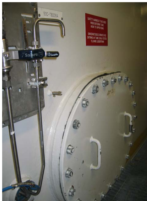
Figur 9.3: Bildet viser lett tilgjengelig prøvetakingskran og mannhull for drikkevannstank (Foto: Eyvind Andersen)
