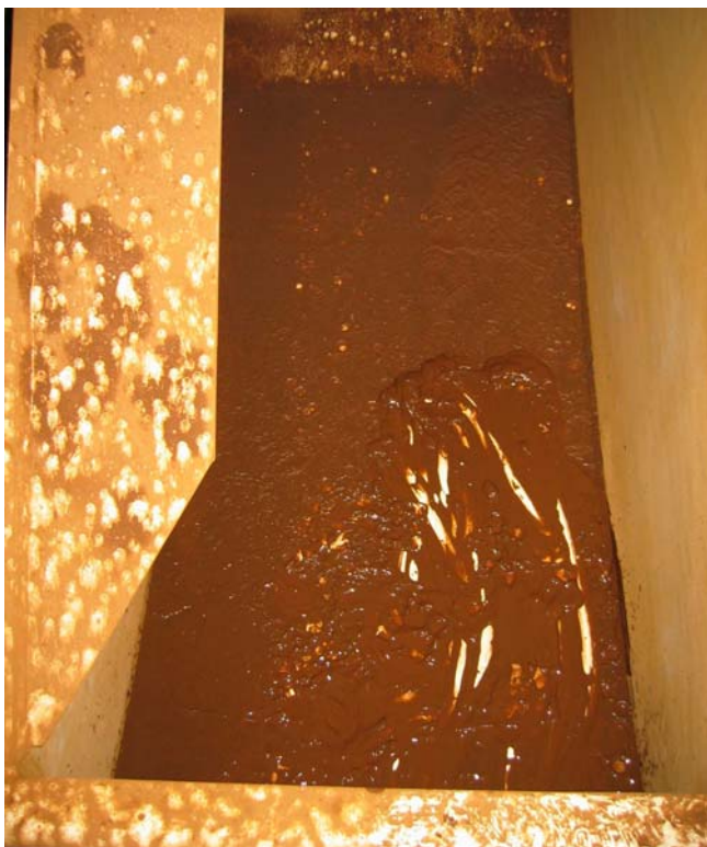
Figur 3.1: Kravet til årlig tankvedlikehold er satt for å unngå tilstander som dette, hvor det nærmest er et gjørmelag i bunnen av tanken. Slike forhold må avviksbehandles (Foto: Bjørn Løfsgaard)
