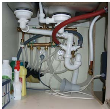
Røropplegg under oppvaskbenk. III.: SINTEF Byggforsk
