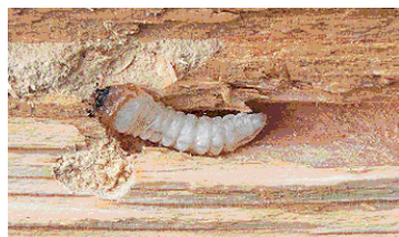
Husbukkklarve og skadet trevirke.
