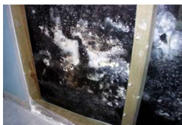
Fuktskade i vegg som har gitt muggvekst. Foto: SINTEF Byggforsk
